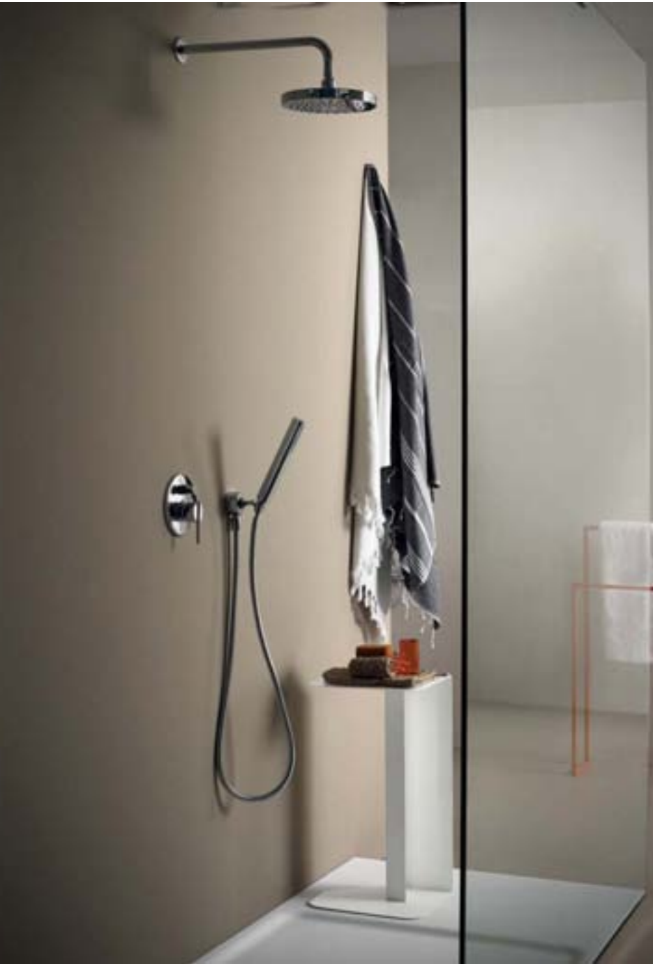
Monocomando incasso vasca-doccia, appendidoccia duplex con doccetta e soffione con braccio doccia a parete.
